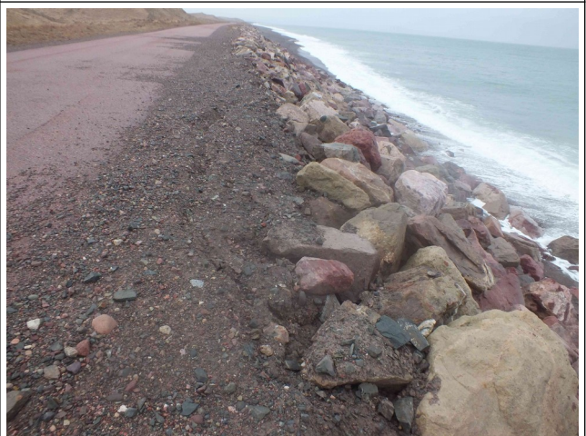
Stabilité de l'affaissement aval
