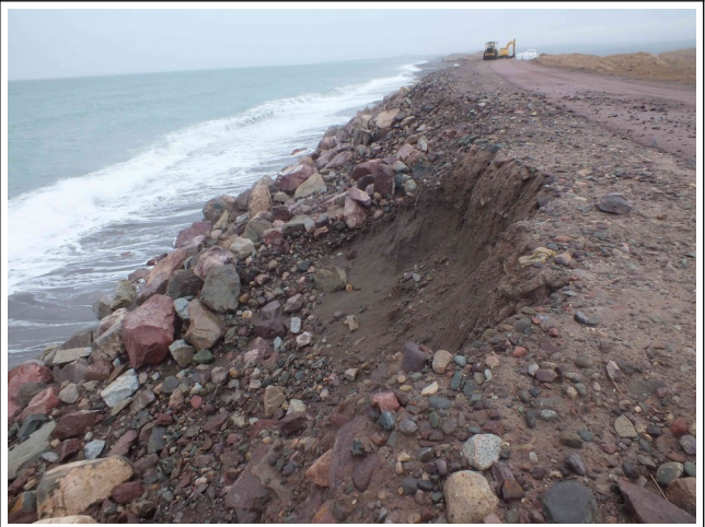
Légère évolution de l'érosion de l'effondrement amont sur la digue
