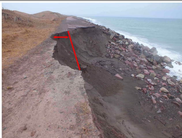
Evolution de l'érosion de l'érosion de l'effondrement aval
