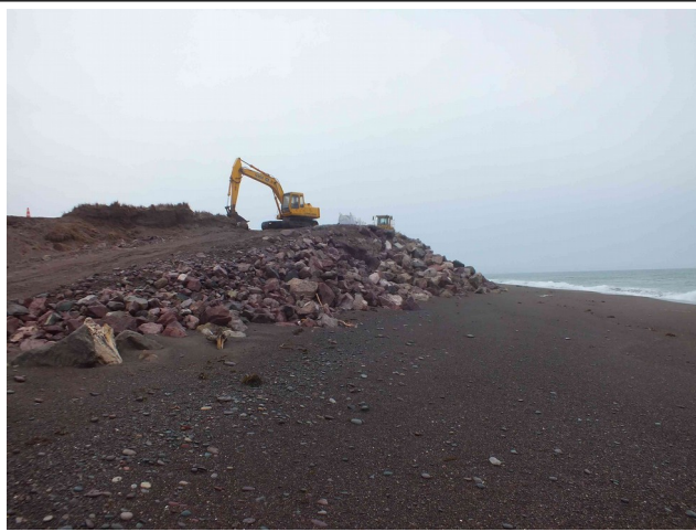
Tassement de l'enrochement sous le parking amont
