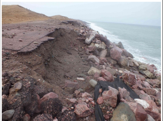
Légère évolution de l'érosion de l'érosion sur la réparation après la plateforme centrale
